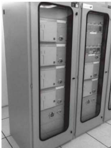
Рис. 4.7. Терминалы МУРЗ, установленные в стандартных шкафах со стеклянными дверями
