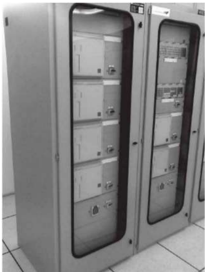
Рис. 7.2. Современный способ монтажа МУРЗ в шкафах
