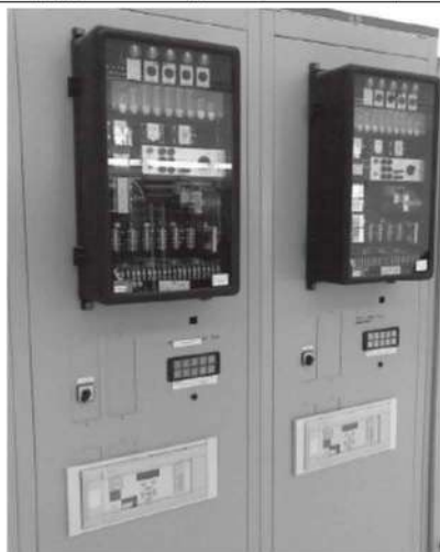
Рис. 5.13. Фрагмент панели дистанционной защиты ответственных линий 160 кВ, содержащей электромеханические реле типа LZ31 (вверху), включенные на параллельную работу с микропроцессорными защитами типа MiCOM P437 (внизу)
