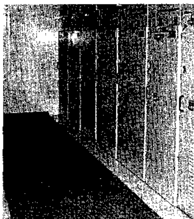
Рис. 4.2.1. Покрытие ПВХ и изоляционный коврик на полу контейнера
