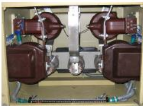
Рисунок 5. Вакуумный выключатель, установленный в ячейку К-112.
