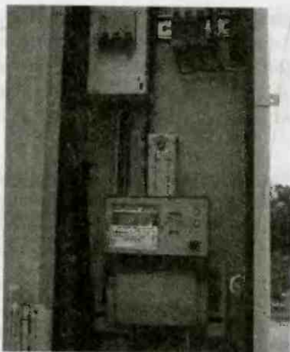
Рис. 7.38. Электросчетчик на щитке
