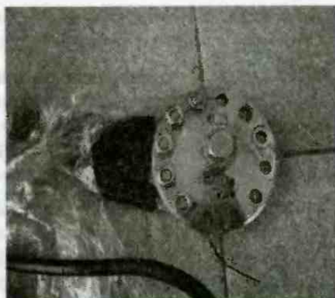
Рис. 7.19. Подобное устройство позволяет заземлить сразу несколько кабелей
