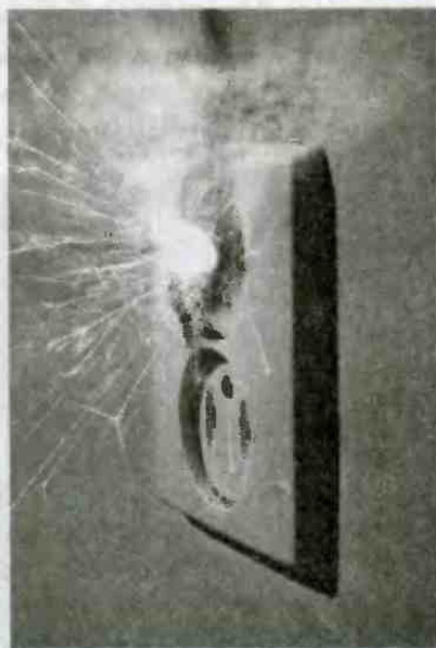
Рис. 6.10. Ошибки в плане электрификации чреваты коротким замыканием и даже пожаром
