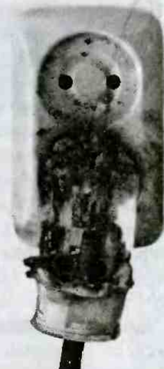
Рис. 1.19. Сгоревшая розетка — это еще не самый худший исход при использовании неисправных электроприборов
