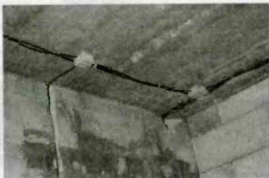
Рис. 4.12. Совмещение открытой (потолок, идет под натяжной потолок) и скрытой (штробы в стенах) проводки
