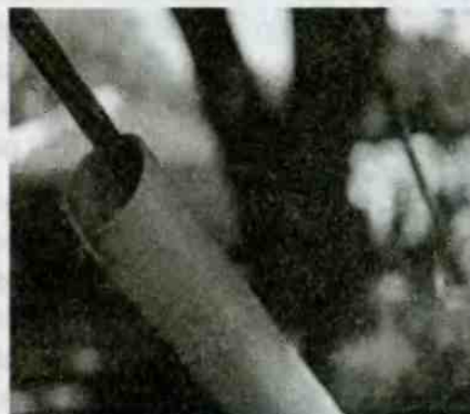
Рис. 7.23. Неизолированные провода в изоляционных трубках
