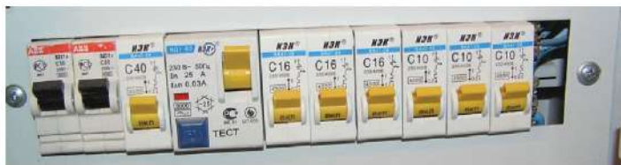
Рис. 10. Автоматические выключатели, установленные в электрошкафу (щитке)
