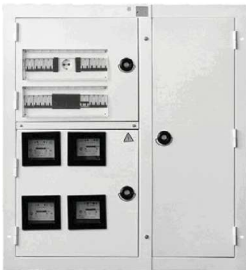
Рис. 6. Вид на электрощит в коридоре на лестничной клетке
