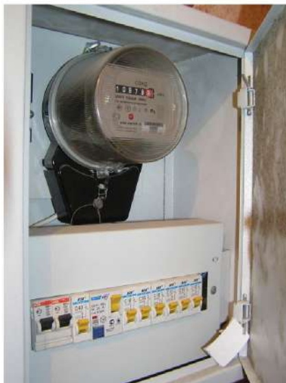
Рис. 5. Внешний вид открытого электрощитка (шкафа) с расположенными внутри выключателями-автоматами
