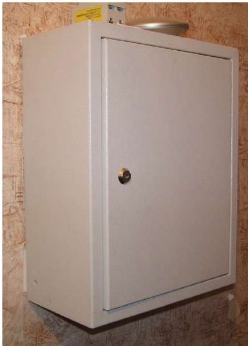
Рис. 7. Электрощиток в квартире
