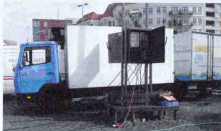
Рис. 2.28. Щит с автоматическими выключателями и УЗО для подключения передвижных торговых киосков (Гамбург, ФРГ)
